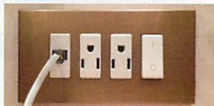
客室内コンセント(イメージ)
